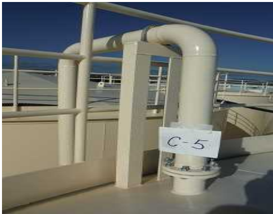
①ベント管外観
