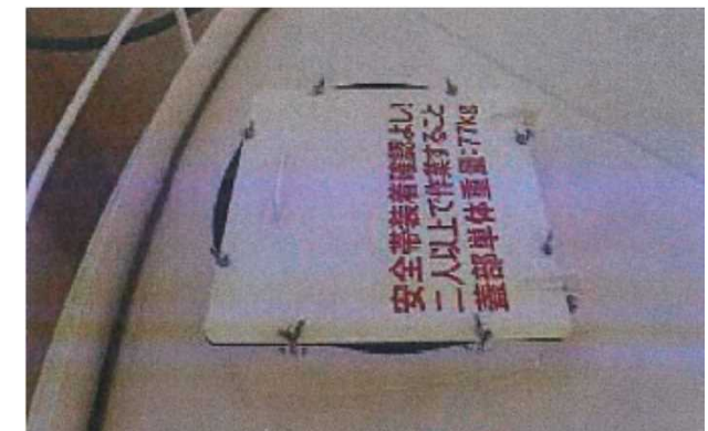
③マンホールパッキンはみ出し
