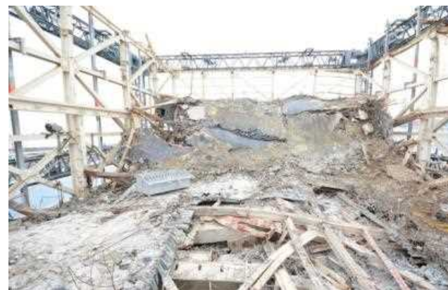
南側崩落屋根の状況
