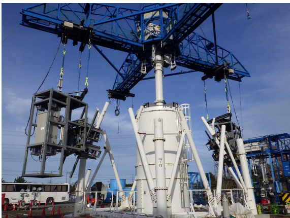
斜材切断の状況
