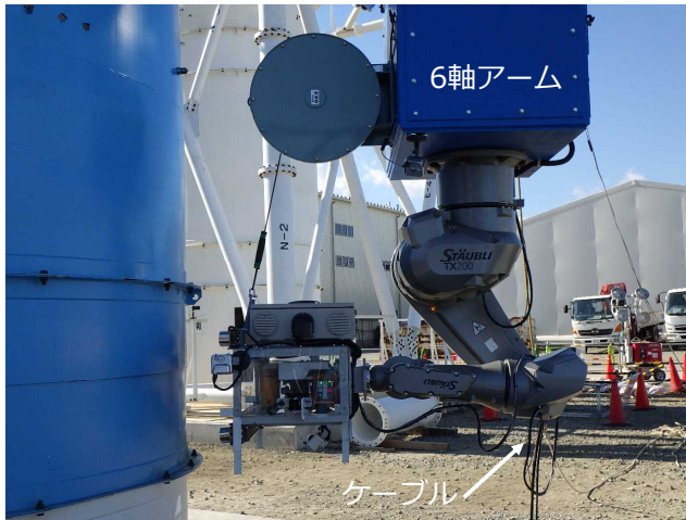
6 軸アーム配線状況
