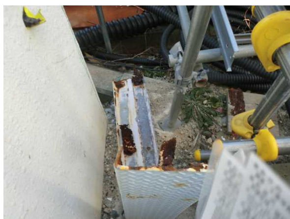
落下した足場
