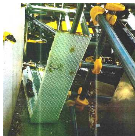
落下した点検用の足場
