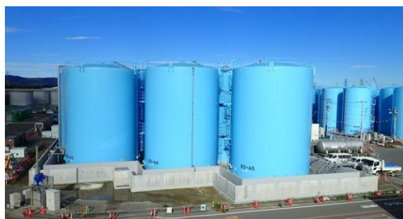
図 4 溶接型タンク
