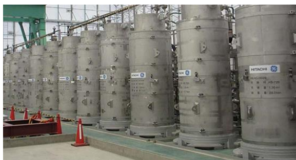
図 3 高性能多核種除去設備
