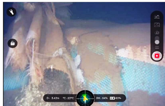
破損している土嚢
