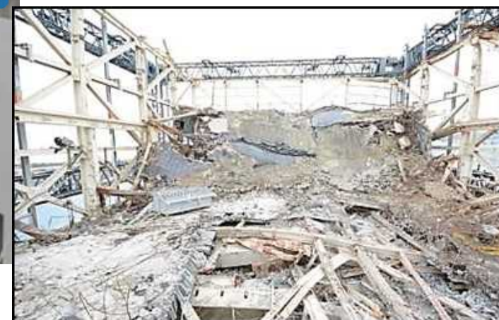
崩落屋根の状況
