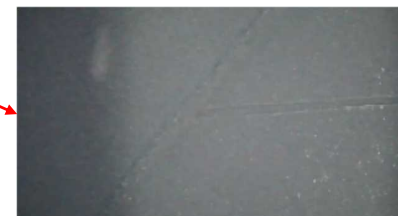
H2-D1タンク内面写真（底板）
