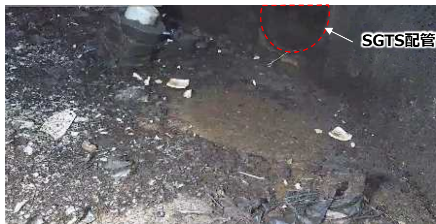
写真：SGTS配管状況(5/20雨天時)
