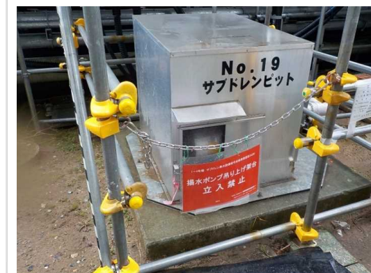
(サブドレンNo.19ピット) 4
