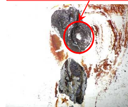
前処理フィルタ2B 漏えい箇所
