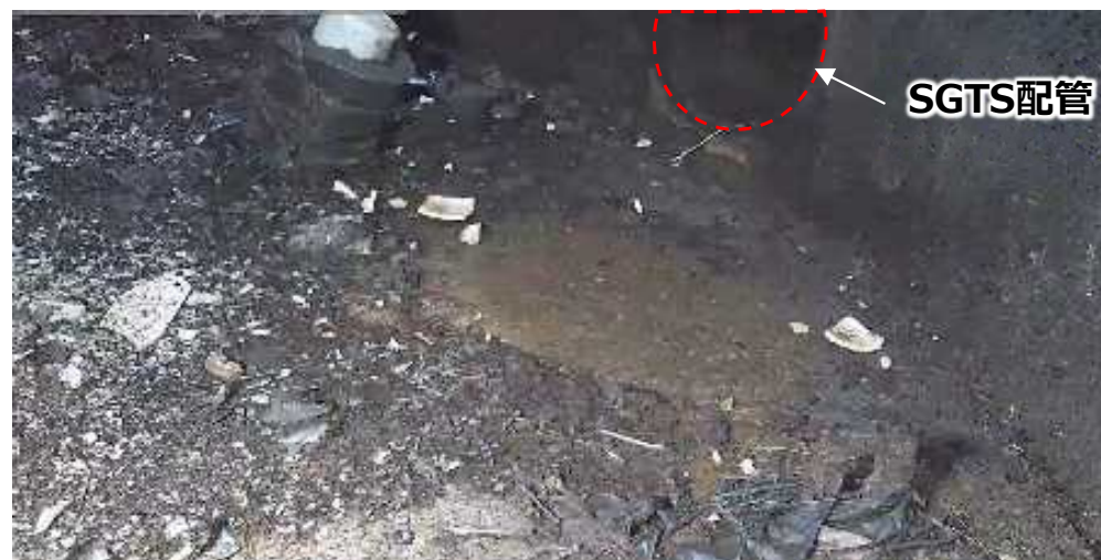
写真：SGTS配管状況（5/20雨天時）
