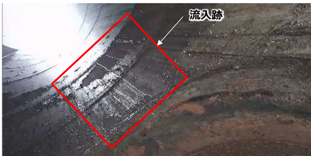
写真：排気筒内面状況（5/20雨天時）
