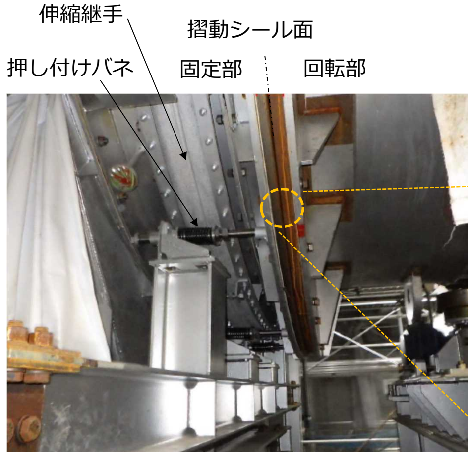
ロータリーキルン シール部 (入口側)
