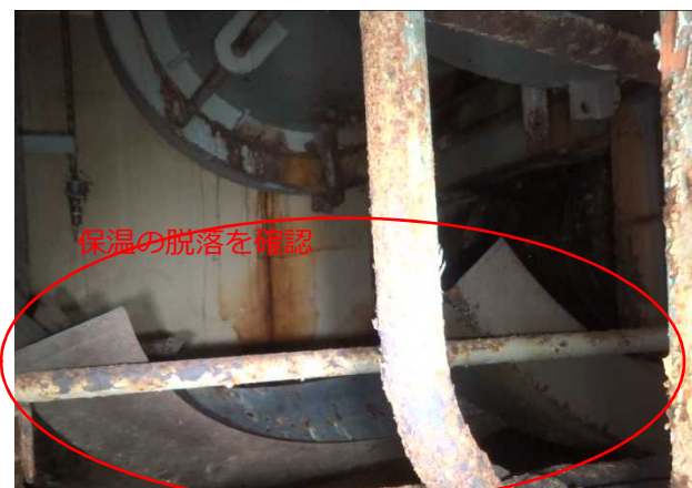
主蒸気配管 B
