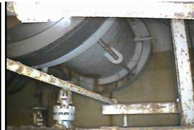
主蒸気配管 C
