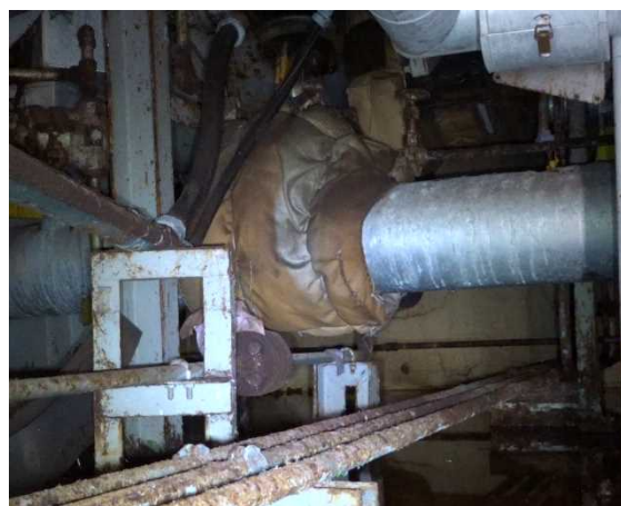
主蒸気系ドレン配管
