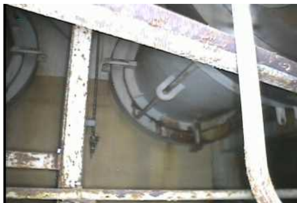
主蒸気配管 B
