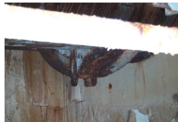
主蒸気配管 C
