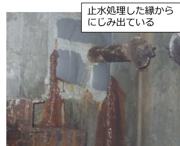
②漏水箇所
