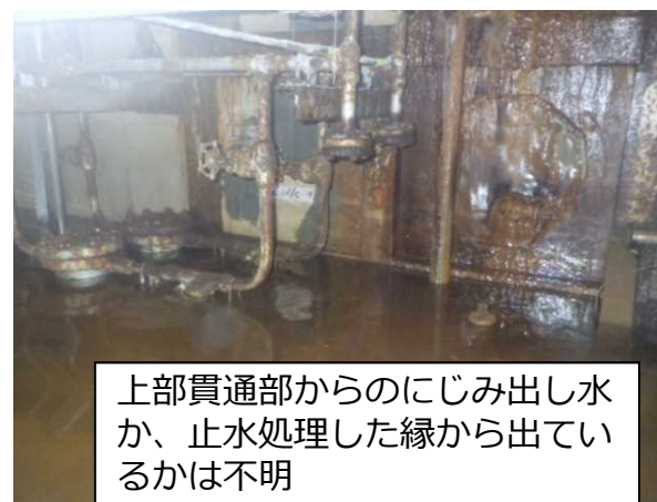
⑬漏水箇所
