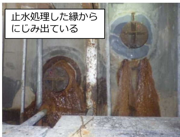
⑩⑫漏水箇所
