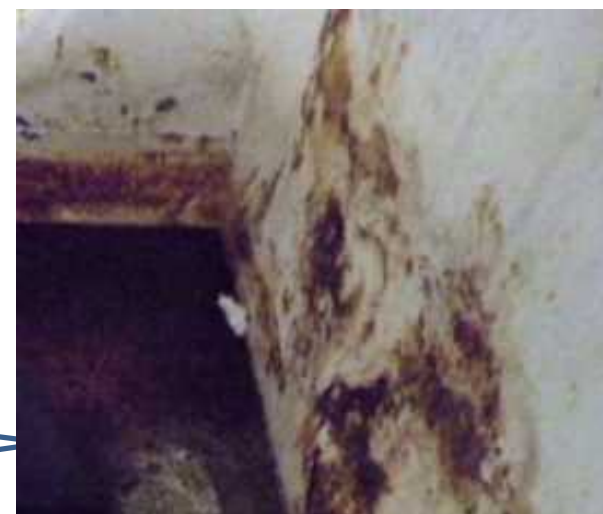
容器内面・補修箇所の状況
