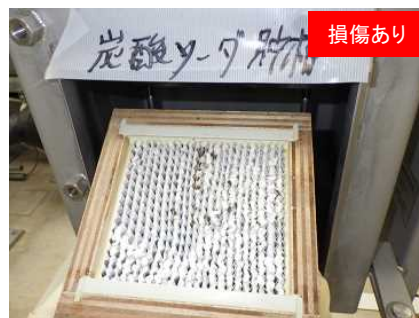
既設ALPS 炭酸ソーダ貯槽
