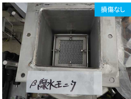
既設ALPS β線水モニター時受 タンク
