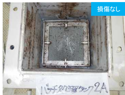
既設ALPS バッチ処理タンク2A
