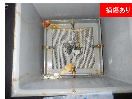
増設ALPS A系共沈タンク
