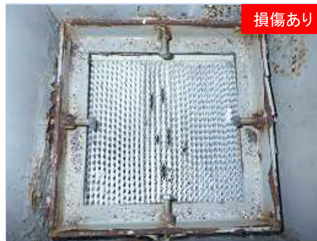
増設ALPS 排水タンク排気フィルタ
