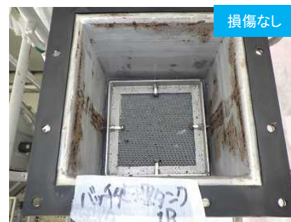
既設ALPS バッチ処理タンク1B
