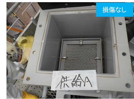
既設ALPS 供給タンクA
