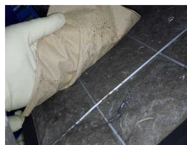
プレフィルタに 水滴付着・破損無し
