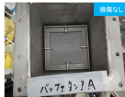
既設ALPS バッファタンクA
