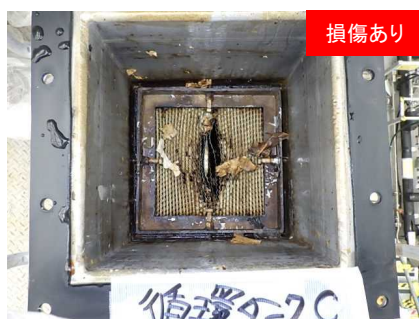
既設ALPS 循環タンクC
