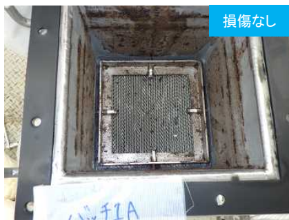
既設ALPS バッチ処理タンク1A
