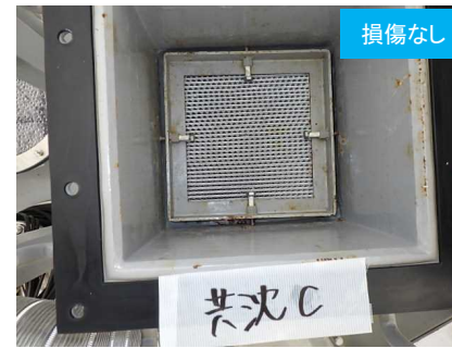
既設ALPS 共沈タンクC
