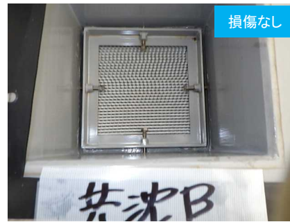
既設ALPS 共沈タンクB
