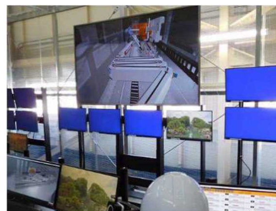
コントロールルーム内状況
