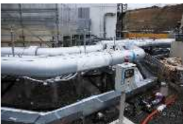
陸側遮水壁ブライン（冷媒）循環配管
