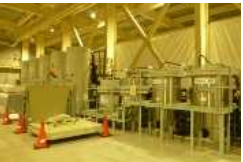
サブドレン浄化設備
