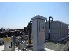
地下水バイパス揚水井
