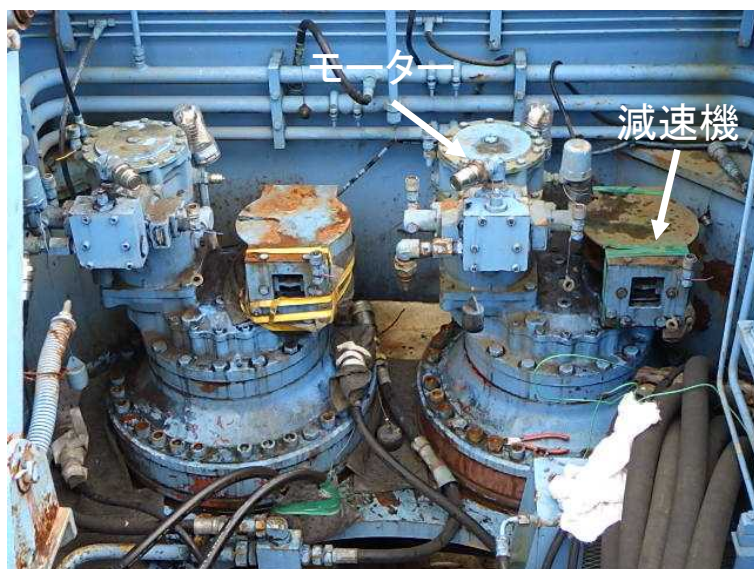
休止中クレーン減速機外観
