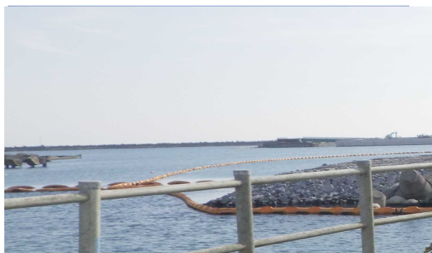
（既設）重油オイルフェンス展開状況
