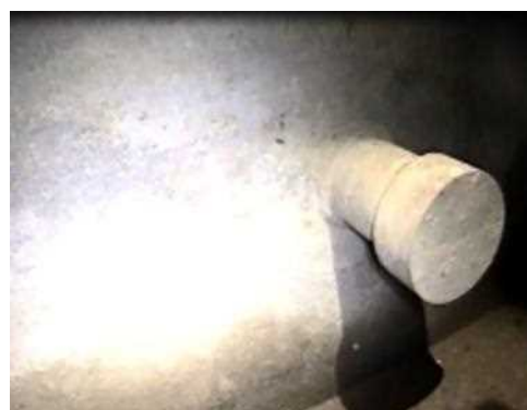
①出口配管
