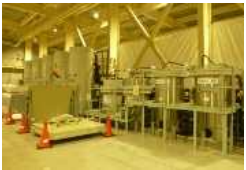
サブドレン浄化設備
