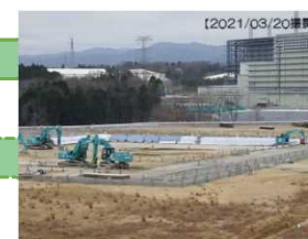
減容処理設備 現場写真
