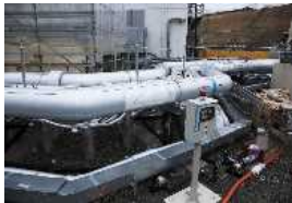
陸側遮水壁ブライン（冷媒）循環配管
