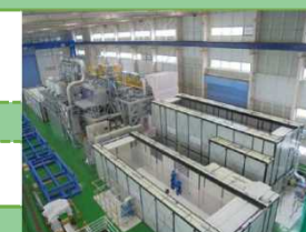
大型機器除染設備 外観
