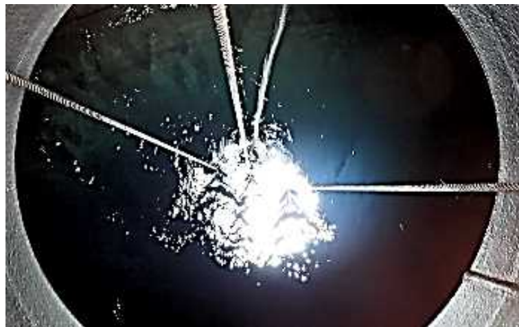
攪拌装置運転時のタンク水面（T/R時に撮影）
