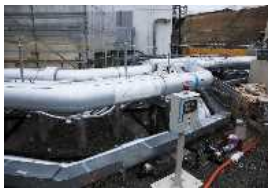
陸側遮水壁ブライン（冷媒）循環配管
