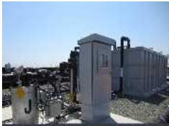
地下水バイパス揚水井
