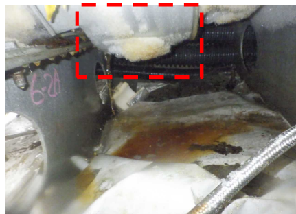
当該漏えい箇所写真 (保温取り外し前)
