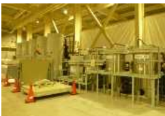
サブドレン浄化設備
