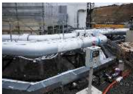
陸側遮水壁ブライン（冷媒）循環配管
