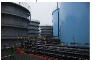
フレンジングタンク、溶接タンク
