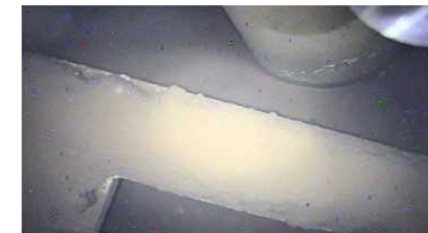
④SFP底部砂礫堆積状況
