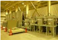
サブドレン浄化設備
