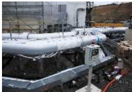
陸側遮水壁ブライン（冷媒）循環配管
