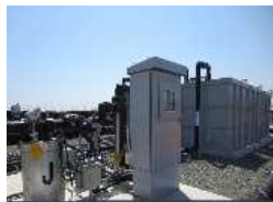
地下水バイパス揚水井
