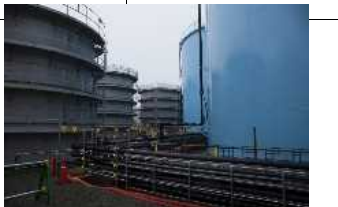
フレンジングタンク、溶接タンク
