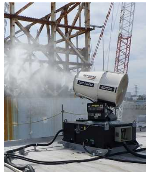
噴霧装置による散水状況
