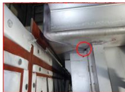
南西角部の溶接部割れ
