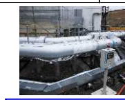
地下水バイパス揚水井
