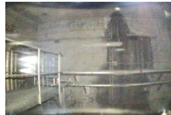
南側側壁（天井貫通部からにじみ） ⇒地上部水溜りあり、ポンプ排水済み
