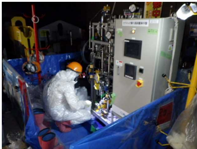
フィルタ通水試験装置写真
