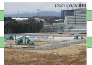
減容処理設備 現場写真
