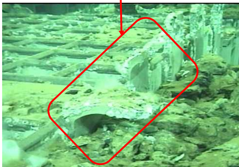
吊りピース変形
