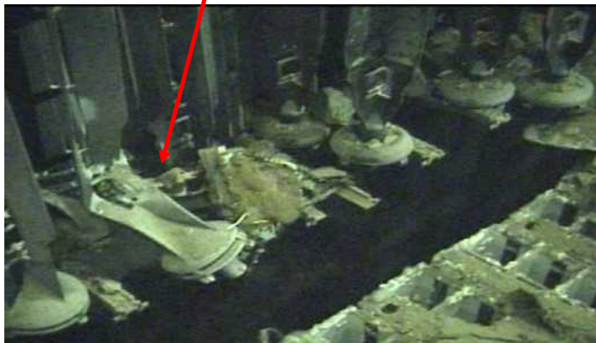
制御棒下部に変形
