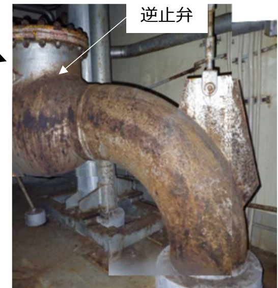
既設CUW配管
