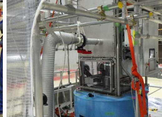
換気ユニットの換気風量確認
