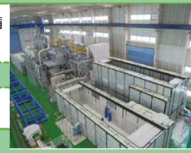
大型機器除染設備 外観
