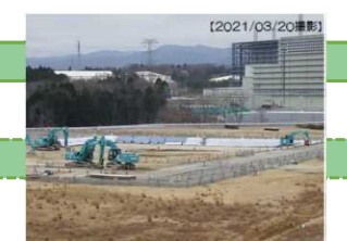
減容処理設備 現場写真
