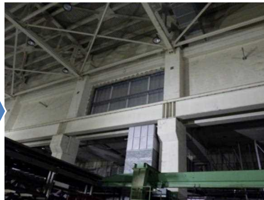
写真②：BOP損壊部分（塞ぎ後、屋内側）
