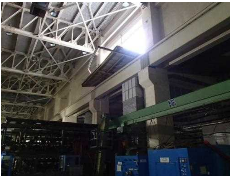
写真①：BOP損壊部分（塞ぎ前、屋内）
