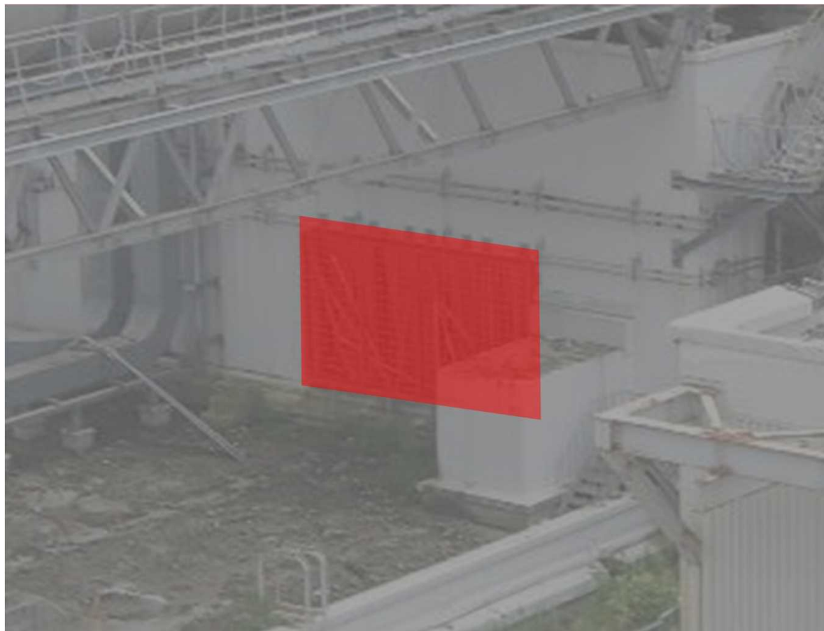
参考写真：雨水侵入箇所
