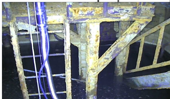
②西（階段、空調設備）
