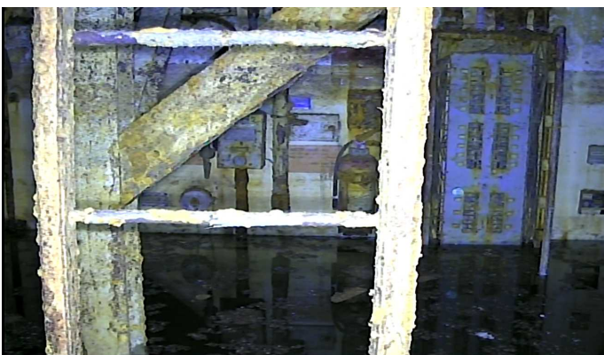
④西（壁面、制御盤）
