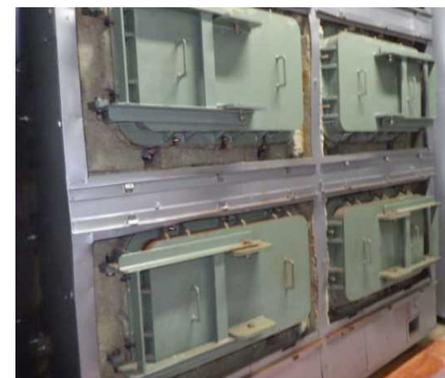
排ガスフィルタ外観
