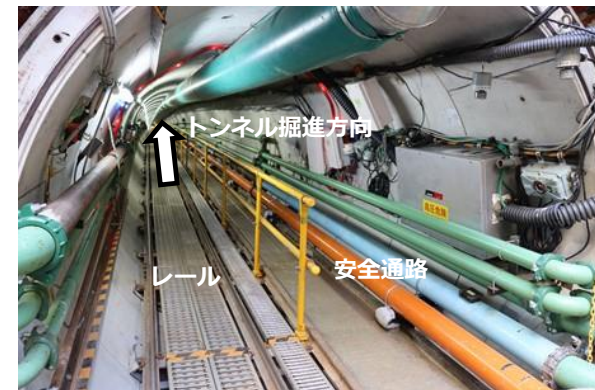
トンネル内部安全設備の整備状況
