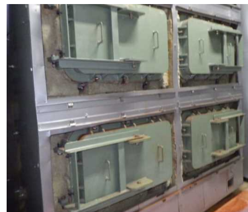
排ガスフィルタ外観
