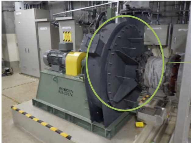
排ガス補助ブロア外観
