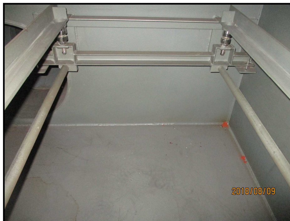
排ガスフィルター（B）内部写真
