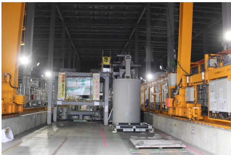
増設多核種除去設備 (ALPS)
