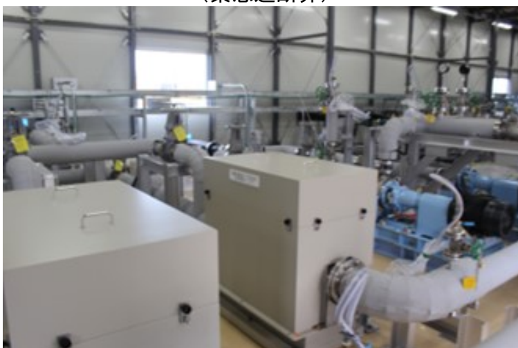
ALPS処理水移送設備 (処理水移送ポンプ出口放射線モニタ)
