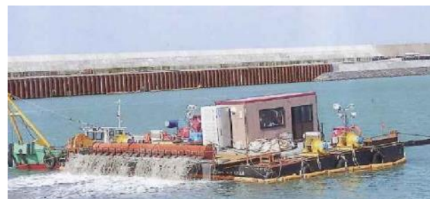
堆砂の撒きあがり防止のため、セメント系材料による覆土の前に、砂を海水と混合しユニフロート台船から撒きます。
