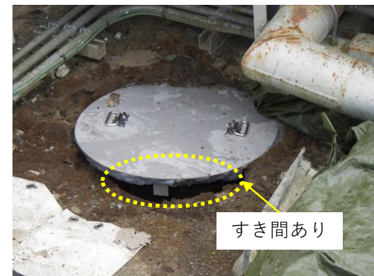
サンプ南東部のマンホール
