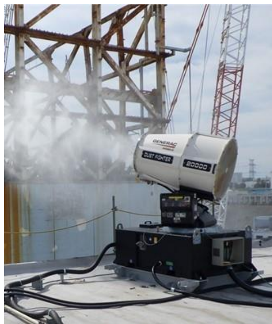
噴霧装置による散水状況
