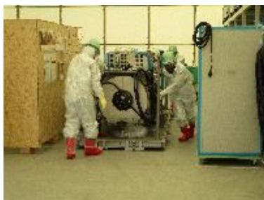
堆積物除去装置 （高圧水、AWJ）設置
